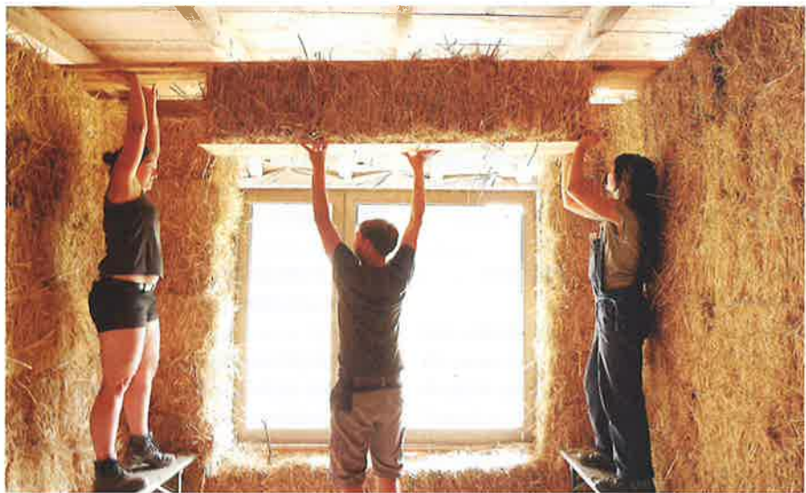
Auf der Mitmach- und Lernbaustelle „Strohraum am Apfelbaum“ wird der Fenstersturz eingesetzt Foto: Lisa Würzebesser / Christina Ebisch
